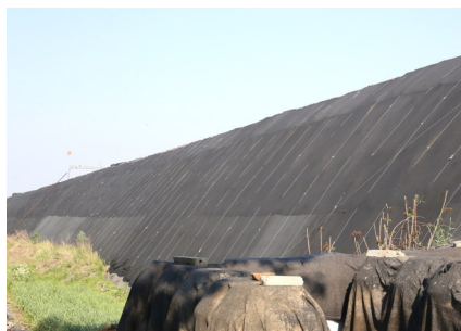
大棚后墙防水
