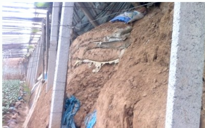
防护不及时坍塌的后墙
